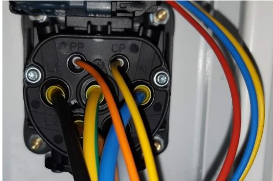
Figura 9: presa della stazione di ricarica
