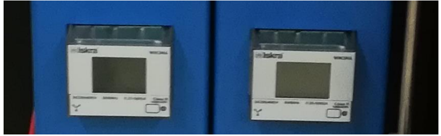
Figura 11: misuratore MID installato all'interno della stazione di ricarica
