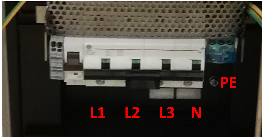
Figura 14: collegamento della stazione di ricarica alla rete elettrica
