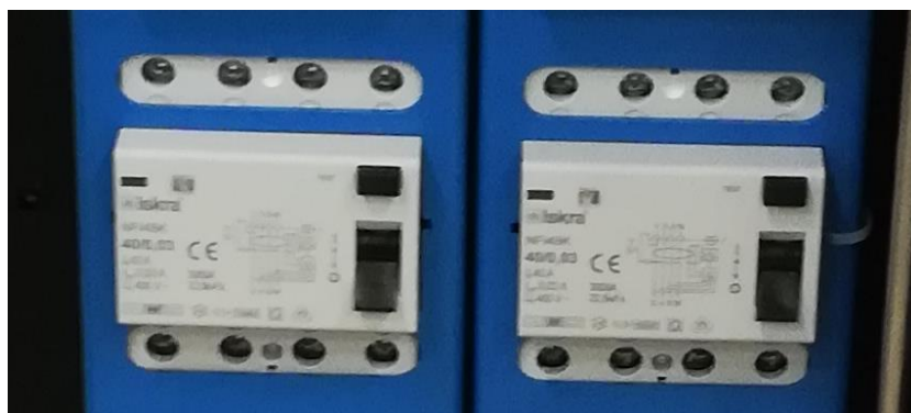
Figura 13: RCD installato all'interno della stazione di ricarica
