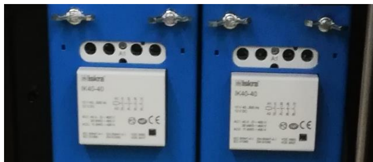
Figura 8: contattori all'interno della stazione di ricarica INCH DUO
