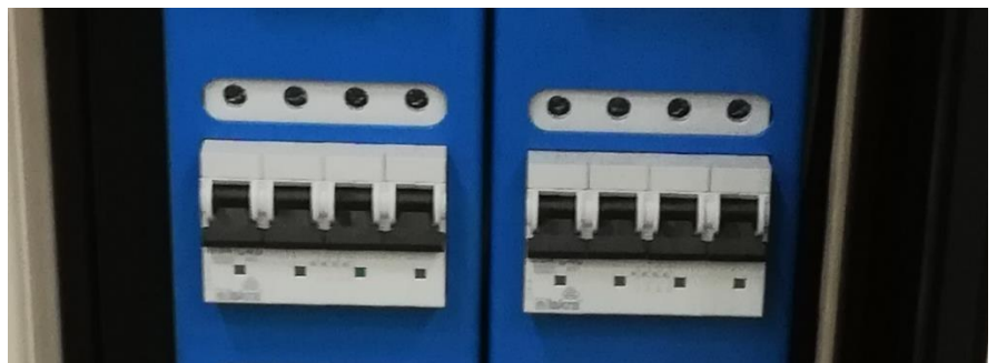
Figura 12: protezione da sovracorrente installata all'interno della stazione di ricarica
