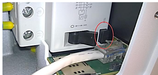
Slika 34: Gumb za testiranje FID sklopke (RCD)
