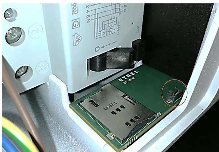
Figur 8: Återställningsknapp inuti underhållsöppningen
