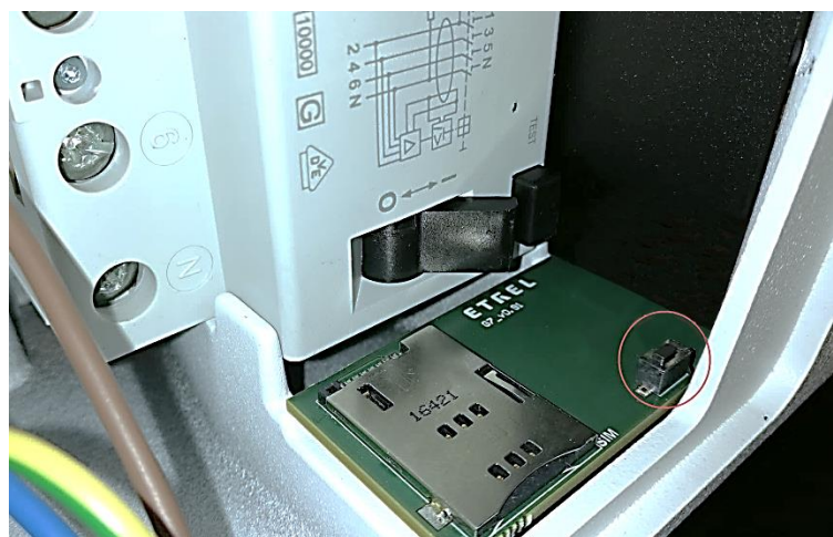
Figura 8: Botón de reinicio dentro de la abertura de mantenimiento
